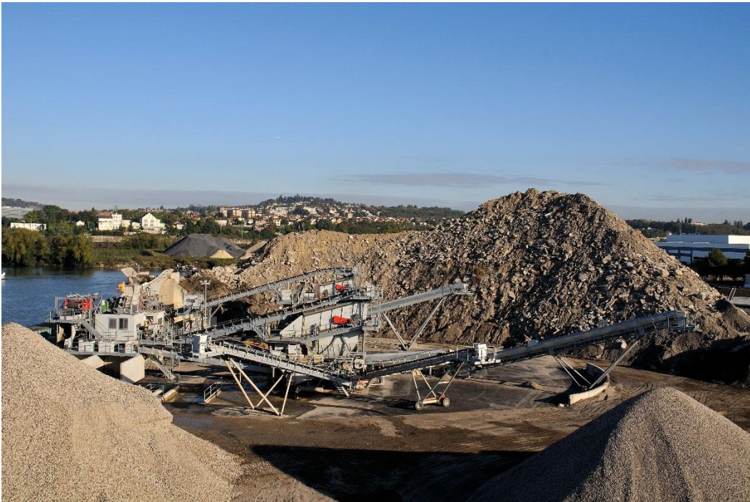
La plateforme de recyclage SPL d'Eurovia à Gennevilliers. - © AxelHeise
