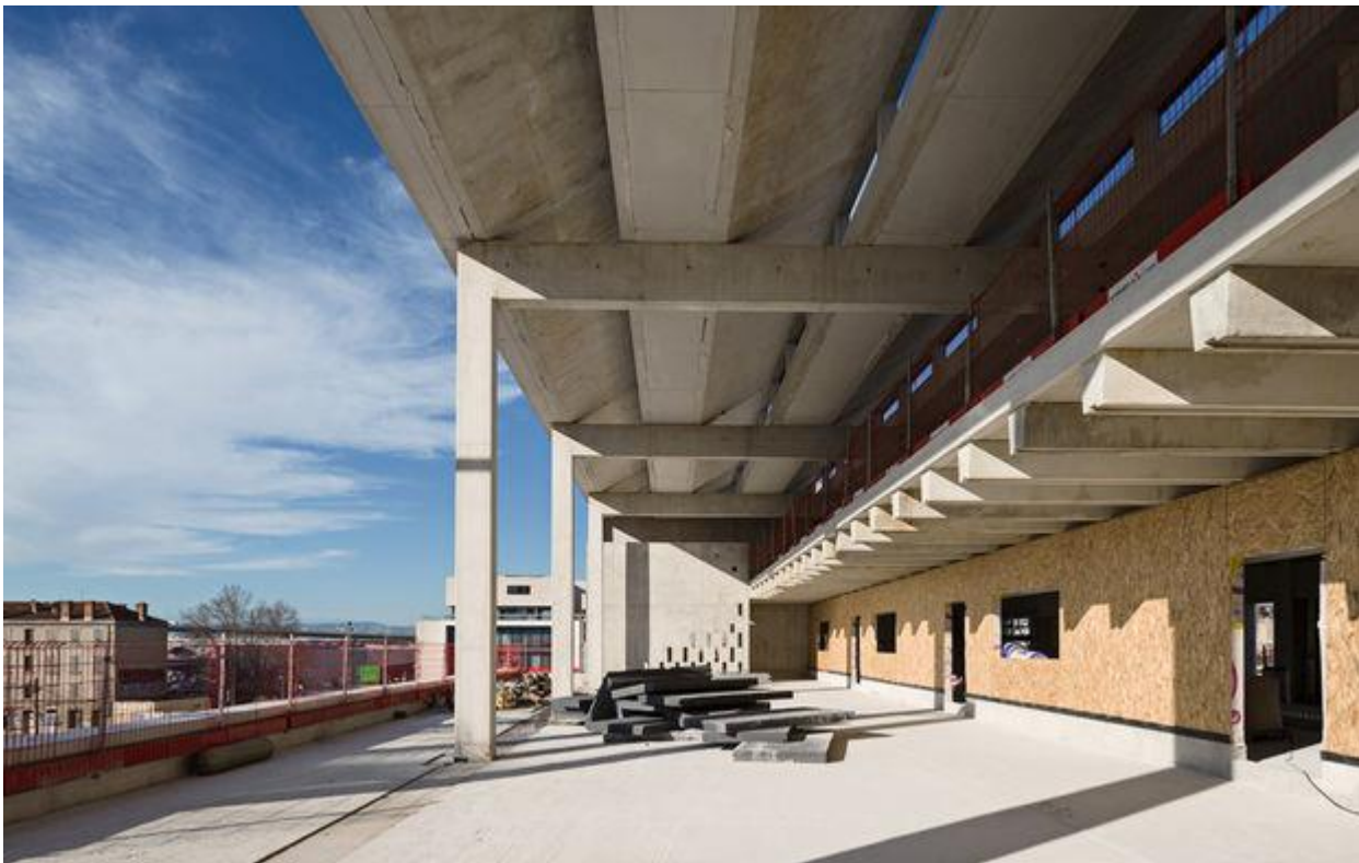
A R+2, le préau de l'école élémentaire est protégé par des sheds en béton.
