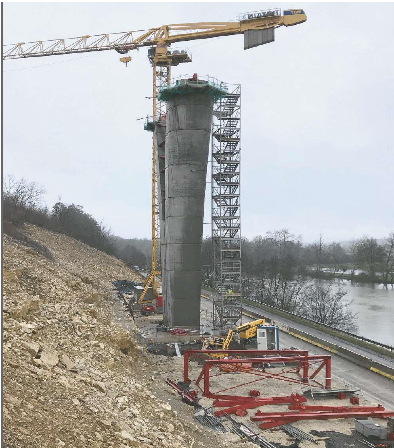
Au niveau de la dernière pile, une paroi clouée assure la stabilisation du talus. - © VERDI INGÉNIERIE
