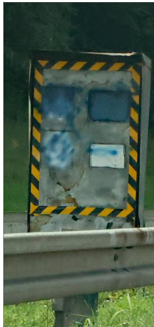
Le radar implanté sur l'A320, à hauteur de être vandalisé. Photo RL/Stéphane STIFTER
